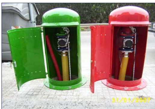
Figura 4: Sistema de riego y limpieza con aguas freáticas en Calafell (Tarragona)
