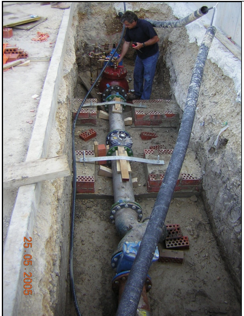
Trabajos de instalación de contador sectorial (300 mm) y regulación de presión por demanda
