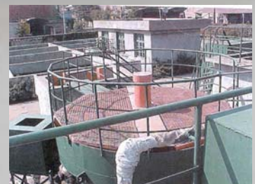
Unidad de tratamiento de aceites
