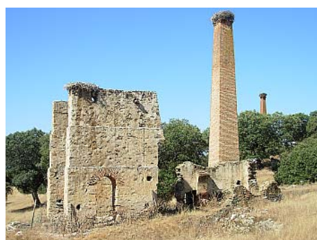
FIGURA 13: Restos de instalaciones en antigua explotación de Pb – Zn en el término municipal de Plasenzuela. Coronando las chimeneas y otras edificaciones pueden verse nidos de cigüeña.
