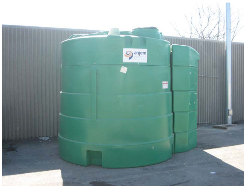
Figura 9. Tanque de biodiésel ubicado en las instalaciones de LATBUS
