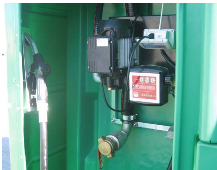
Figura 10. Surtidor de biodiésel anexo al tanque
