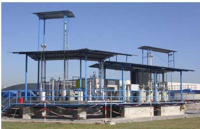
Figura 1. Vista general de la planta piloto
