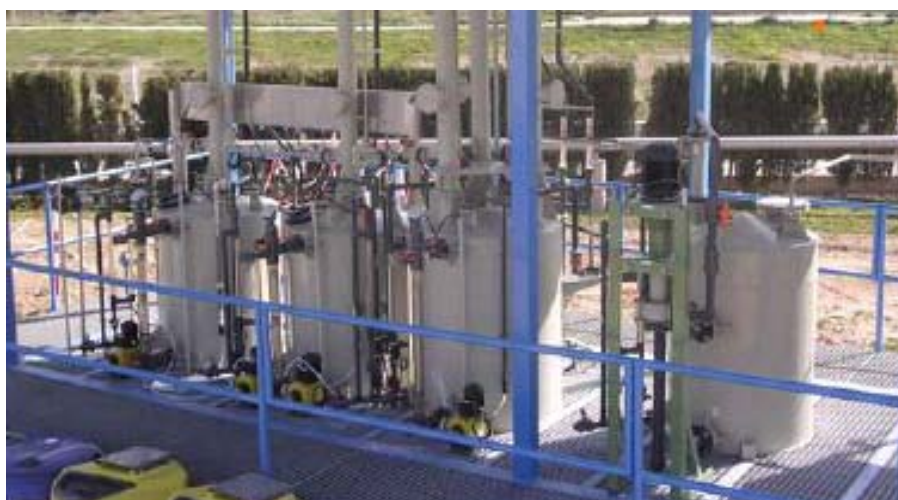
Figura 2. Etapa de limpieza del biogás
