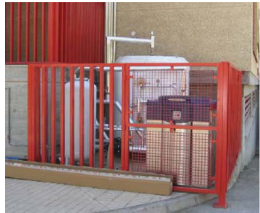
Figura 26. Instalación del CIFEA de Molina de Segura.
