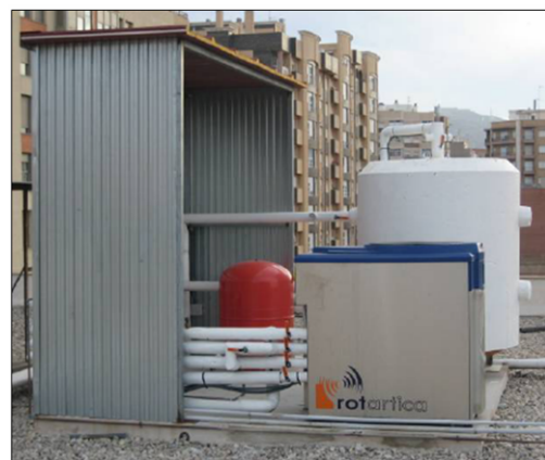
Figura 28. Instalación de la UPCT.
