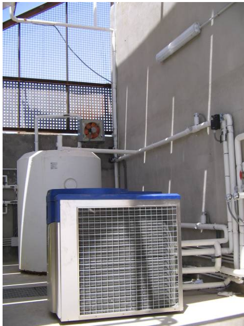
Figura 14. Vista general de la instalación, acumulador, circuitos hidráulicos y máquina de absorción.
