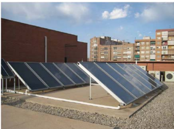
Figura 27. Campo solar de la UPCT.
