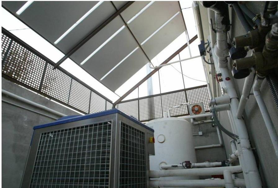
Figura 11. Vista general de la instalación ABSORPILOT.
