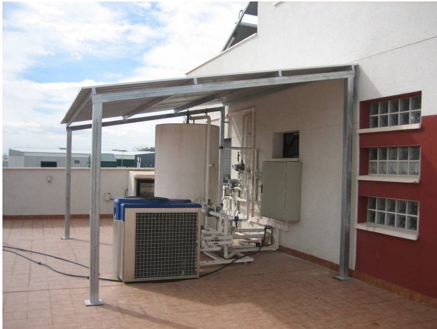
Figura 21. Vista general de la instalación FRIOSOL MOLINA.
