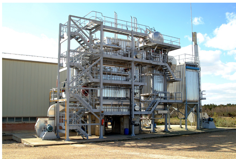
Figura 2. Planta de combustión en lecho fluidizado burbujeante de 3.5 MWt
