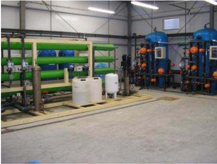
Planta de Tratamiento de Agua de Aporte
