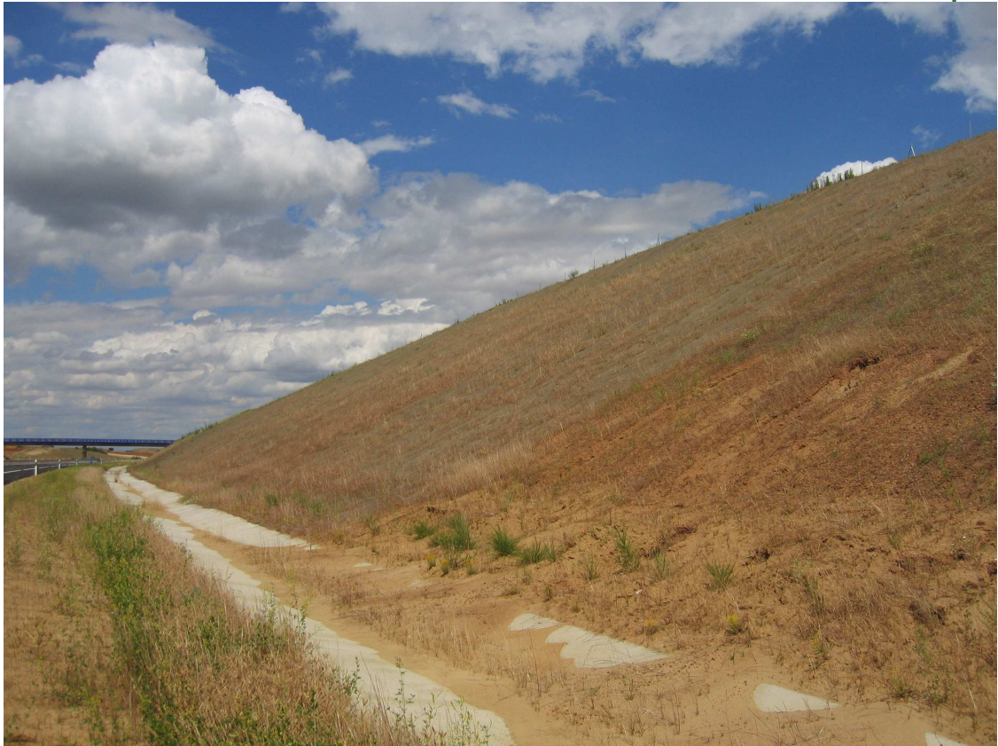
Foto Autovía Benavente- León: taludes hidrosembrados sin y con tratamiento de cobertura de manta orgánica
