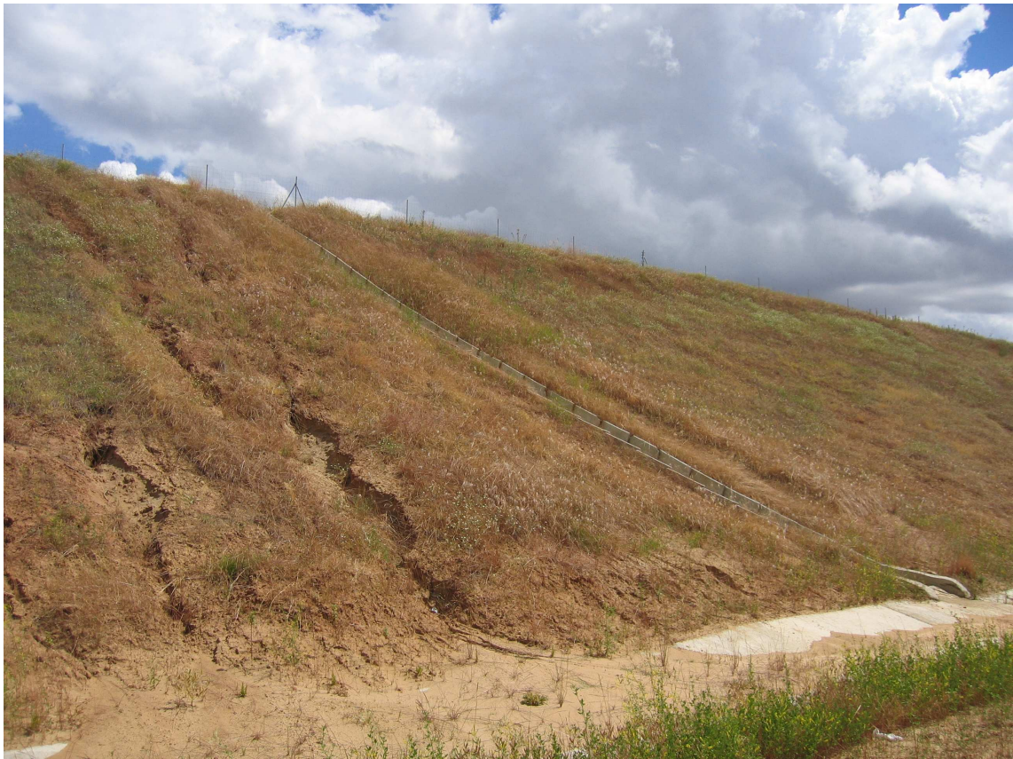
Foto.- Bajante de aguas de piezas prefabricadas que no cumple su función de recogida,
