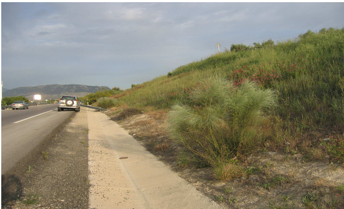
Foto: A 44. Jaén. Talud estabilizado definitivamente pero en el que se observan daños por herbicidas sobre las plantaciones y siembras de borde.
