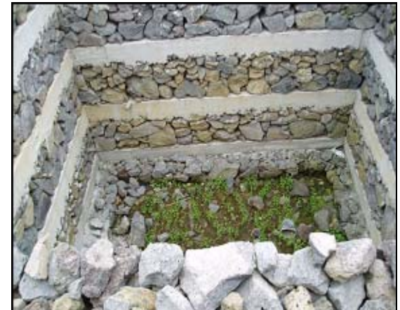
Interior pozo infiltración
