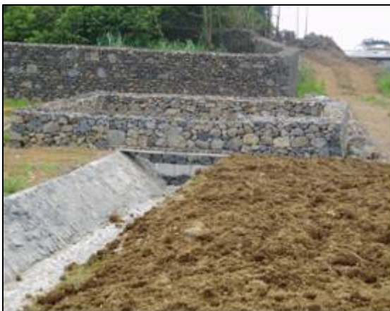
Drenaje desembocando en pozo infiltración
